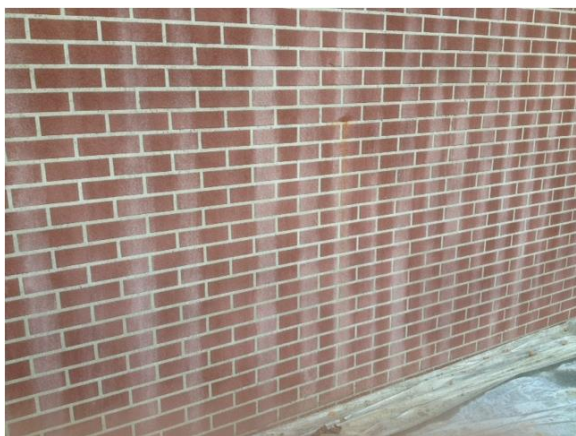
Kalkstreepvorming als gevolg van het afstromend dakwater via de wand
